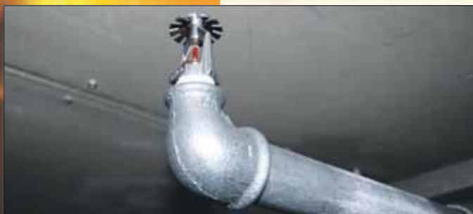
Automaattinen sammutusjärjestelmä toimii tehokkaasti, sillä jokaisessa asuinhuoneessa ja talon yleisissä tiloissa on sprinklerisuutin.
