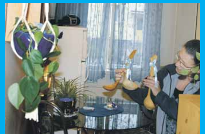
Hannele suunnittelee ripustavansa puukauhoja keittiön sprinkleriputkeen. On kuitenkin tärkeää muistaa sisustussuunnitelmia tehtäessä, ettei sprinklerisuuttimia saa peittää.
